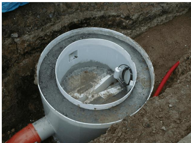
Parshallův žlab v šachtovém dně DN 1000
